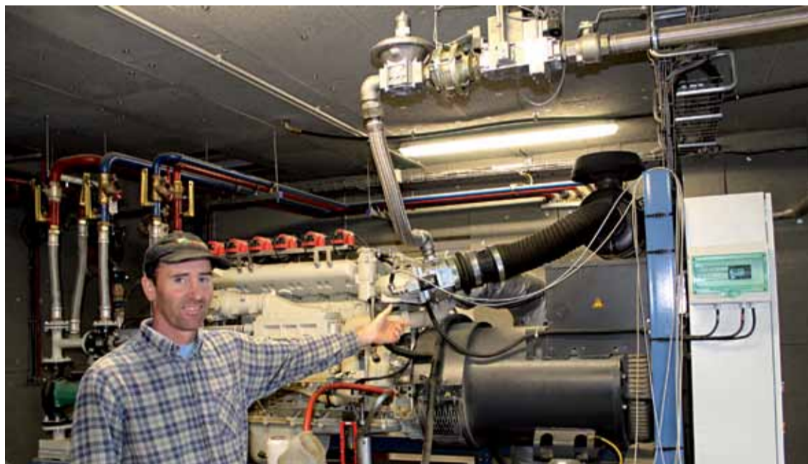
David nous présente le moteur (cogénération) qui utilise le gaz méthane pour produire de l'électricité et de la chaleur.
